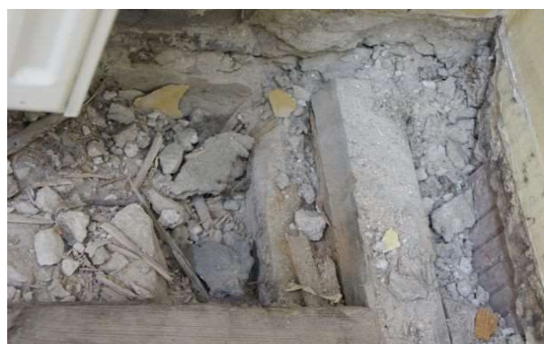
odkrywka stropu n.parterem z 7.03.2020r
